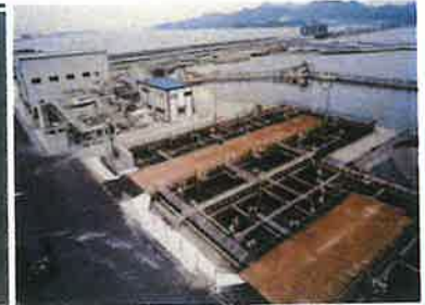
脱水処理設備
